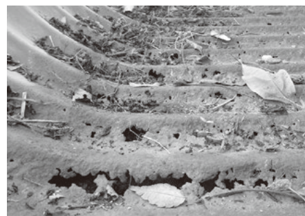
腐食したU字溝
