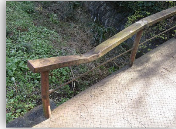
変形・欠損 倒木により防護柵が変形している状態
