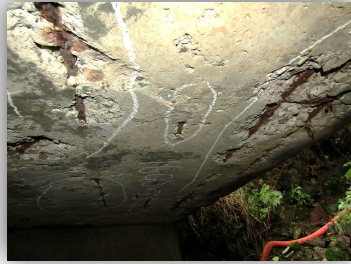
剥離・鉄筋露出 コンクリートが剥離し鉄筋が見えている状態
