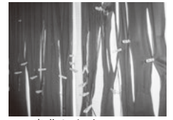
劣化したカーテン
