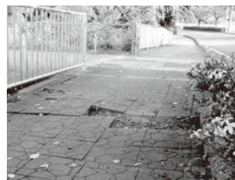
波打つ歩道の平板ブロック
