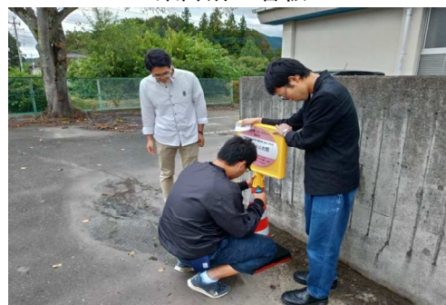
図-1-10 「デマンド乗り合いタクシー」の看板設置時の様子
