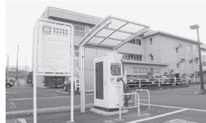
長瀬町で設置した急速充電設備
